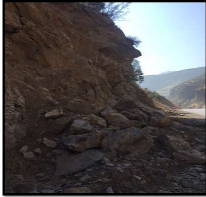
الصورة (٨) تساقط الكتل الصخرية
